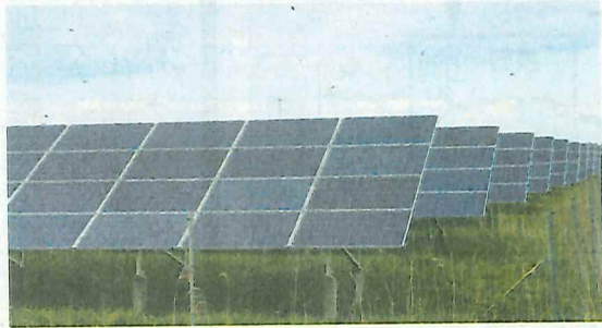
太陽光パネル
