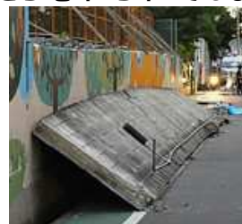
地震で倒壊したブロック塀
