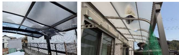
↑壊れたカーポート ↑壊れたテラス
